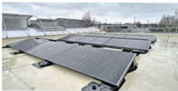
Die Photovoltaik-Anlage auf dem Dach soll in den kommenden Wochen in Betrieb genommen werden.
