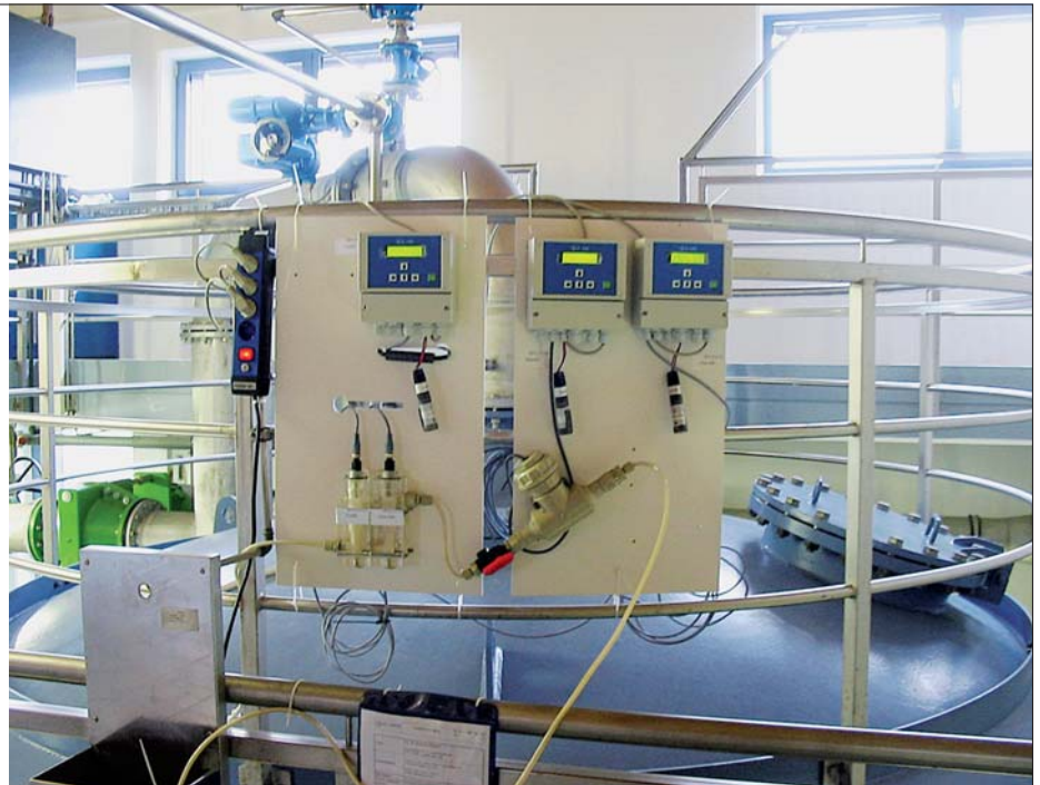
IM FELDTTEST: Aufbau der Messungen im Wasserwerk Willich Bild 4
