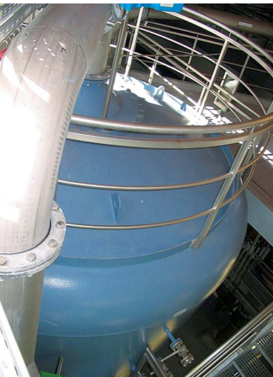
WASSERWERK WILLICH: Bild 1 der Reaktor zur Entcarbonisierung
